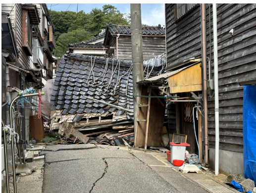
photo. 16 震災後の輪島市内の倒壊した住宅
