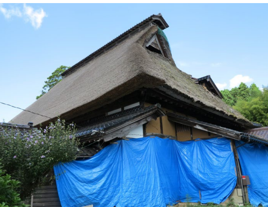
photo. 12 震災後の室木家住宅主屋外壁廻り
