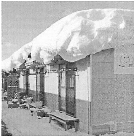
pic. 33 雪氷が屋根水上まで登って窓に下がった様子
